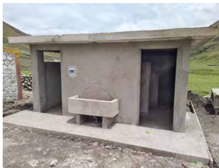
Bouw van toilet- en doucheruimte met warm water van zonne-energie op de basisschool in Chaullacocha.
